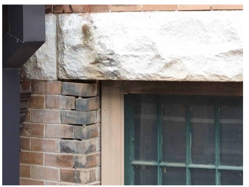
E1 LEVEL 3 - MORTAR DETERIORATION NTS
