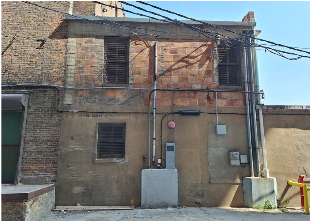
ALLEY - BACK WALL CONDUITS
